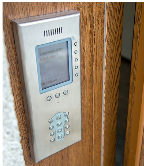
Portarna har fått ett elektroniskt inpasseringssystem.
